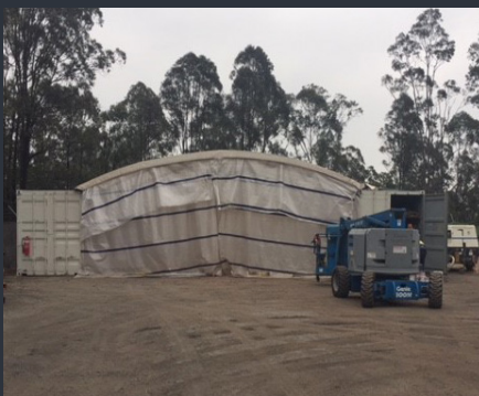
IPCQ Blast & Paint Igloo
